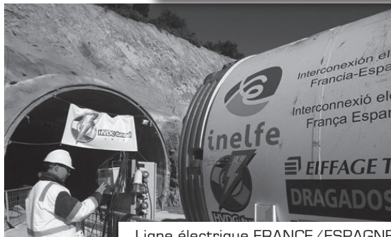
Ligne électrique FRANCE/ESPAGNE
